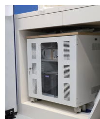
サーバーは頑丈な棚に入れて固定。扉は鍵をかけている。
